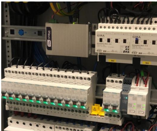
Datei: iHaus Pro in die Hutschiene montiert
