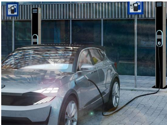
Bild 5: ChargeOne E-Ladeinfrastruktur als elementarer Baustein für smarte Gebäude
